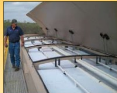
▲ AX-Mobile utiliza un medio filtrante a base de textiles sintéticos capaz de tratar aguas negras y grises a un nivel de tratamiento secundario avanzado.
